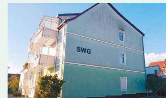
Vorher: Die Schwarzalge hat am Giebel des Hauses in der Waldstraße ihre Spuren hinterlassen.
